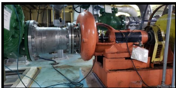
Detalhe - Sucção da Bomba B101-B
