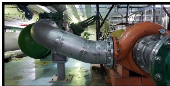
Detalhe - Recalque da Bomba B101-B
