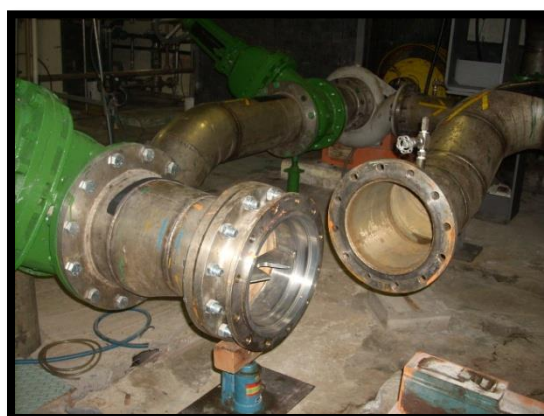
Detalhe dos Tubos de Interligação da Bomba B101-B
